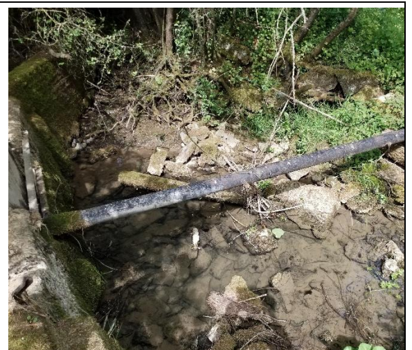
Photo 3. Évacuation par un tuyau
